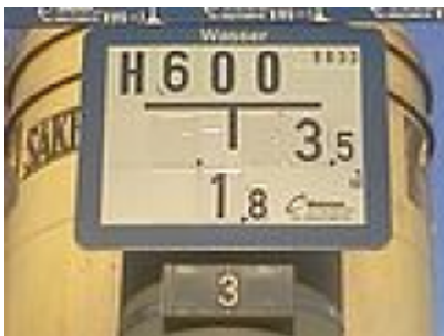
Blaues Hydrantenschild zum Hinweis, dass dieser Hydrant zusätzlich Be- und/oder Entlüftungseinrichtungen für die Leitungswartung besitzt
